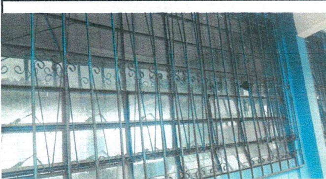
Foto 3: Estas balcones se han deteriorado, donde se les ha caido piezas por lo que es necesario darles un mantenimiento completo.
