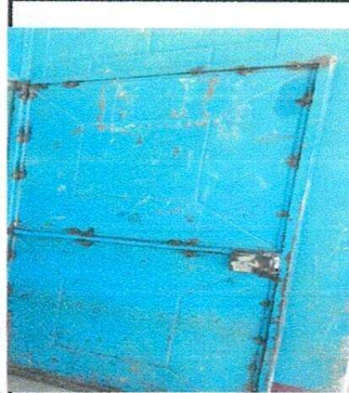
Foto 2: Actualmente son 4 puertas se estan muy deterioradas por lo que es muy importante sustituir las.
