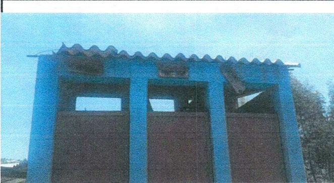
Foto 1: Este modulo de baños es de letrina se reactivarán para baños lavables pero es necesario sustituir el techo.
