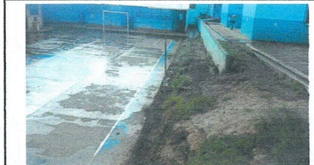
Foto 4: En este parte de la entrada a las aulas de de tierra y en epocas de lluvia se pone muy resbaloso ocasionando daños a los estudiantes por lo que es de urgencia ponerle torta de concreto.
