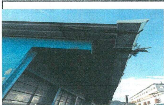
Foto 1: La bajada de agua a través de tubos de pvc en algunas partes se han caído o quebrado por lo que se debe de sustituir algunas bajadas.
