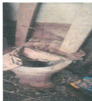
Foto 4: Actualmente hay un modulo de baños que son de letrina pero en desuso por lo que se van a sustituir por inodoros lavables.
