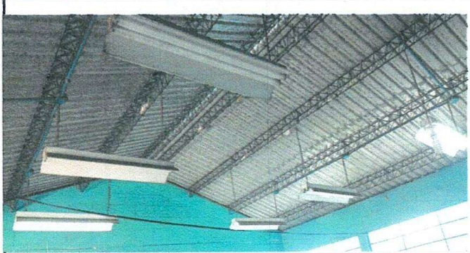
Foto 1: En algunas aulas las lamparas se han quemado por lo que se deben de sustituir.
