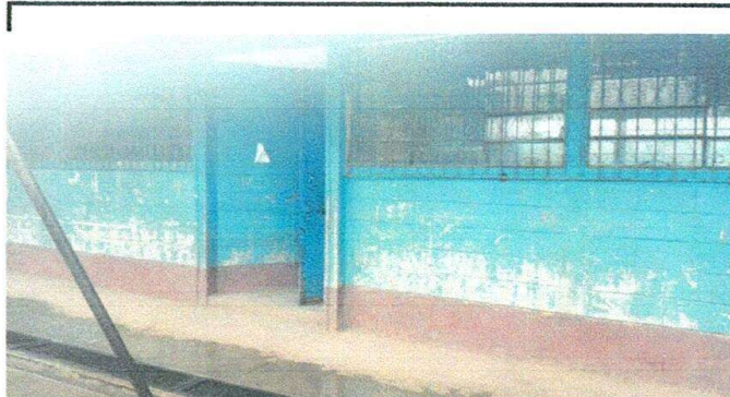
Foto 2: Todas las se mantienen de esta forma donde las paredes especialmente el exterior se ha despintado por lo que se debe de pintar.
