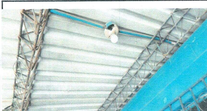
Foto 3: Muchas plafoneras se han roto o quemado se deben de sustituirlos.
